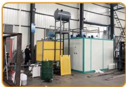
重庆烘房 Chongqing baking room
